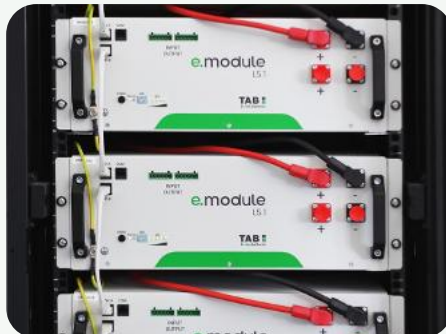
Łańcuch modułów w szafie rack 19"
