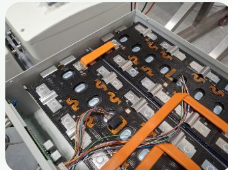
Submoduły 1P8S, szyny i BMS — montaż w Słowenii
