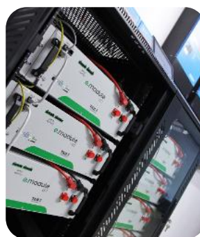
Rozbudowa systemu o kolejne moduły
