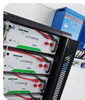
Instalacja z inwerterami Victron Energy
